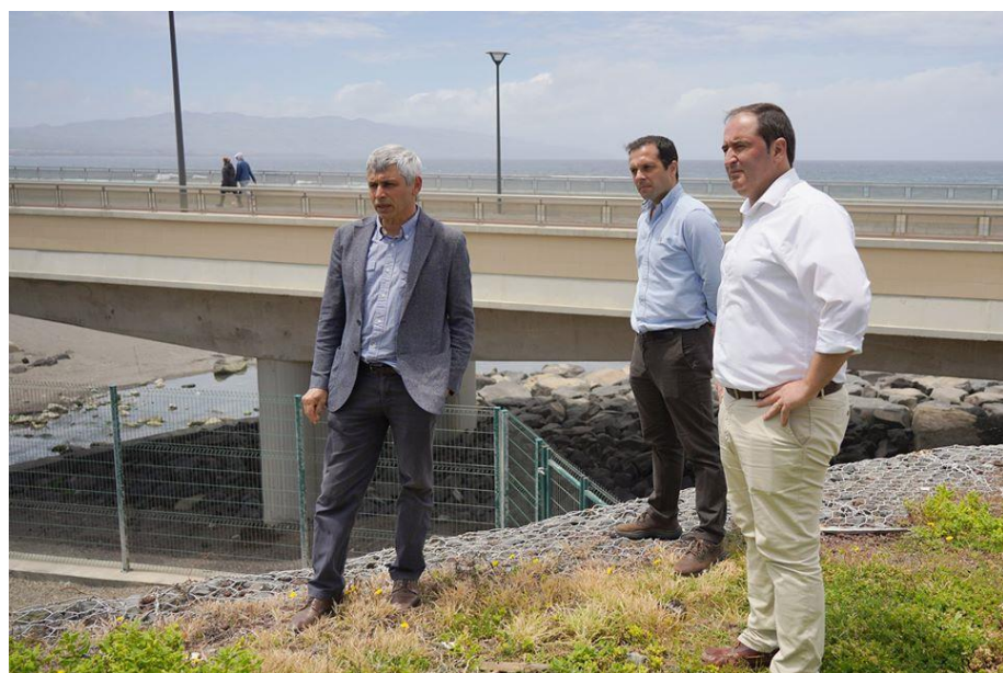
Legenda: Visita do Vereador e do Presidente da Câmara Municipal, e do Presidente da Junta da Matriz ao local onde decorrem as obras.
